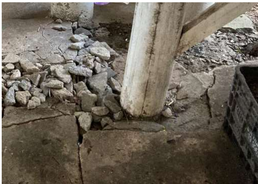
FIGURA 09 – VISTA DAS CONDIÇÕES PRECÁRIAS DO PISO
