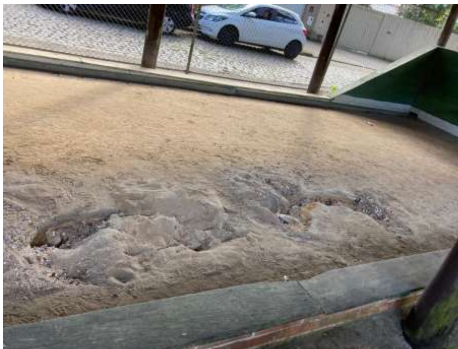
FIGURA 10 – VISTA DAS IRREGULARIDADES DA CANCHA DE BOCHA
