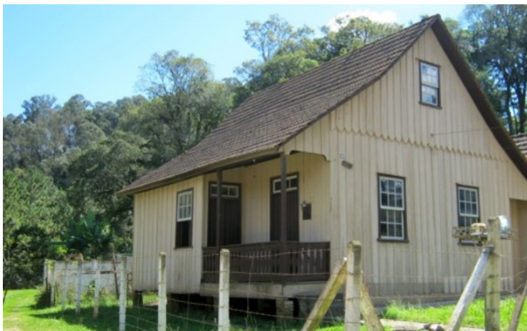
Casa de madeira em mata-junta na divisa de Curitiba com Almirante Tamandaré PR Brasil [Acervo dos autores]
